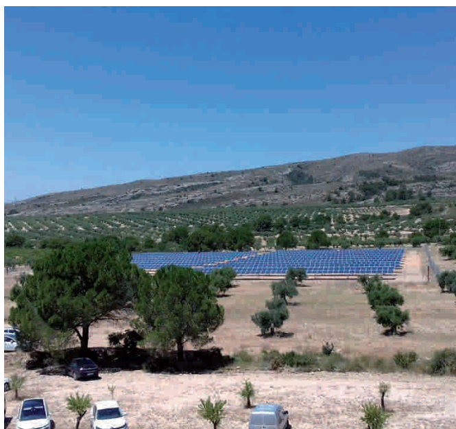
Placas solares, sistema de riego Villena.
